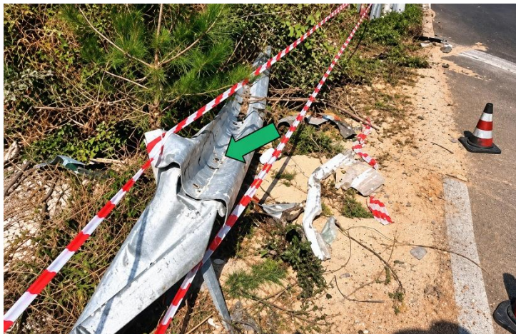
ภาพที่ 8.22 ภาพถ่ายถนน ระยะที่ 4 จุดชน/กระแทก
